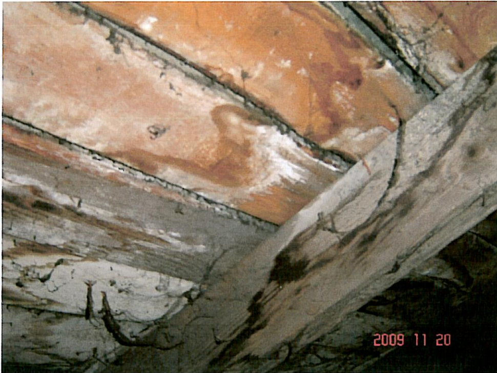
Fot nr 5. Liczne zawilgocenia poszycia dachu ze śladami grzyba jw
