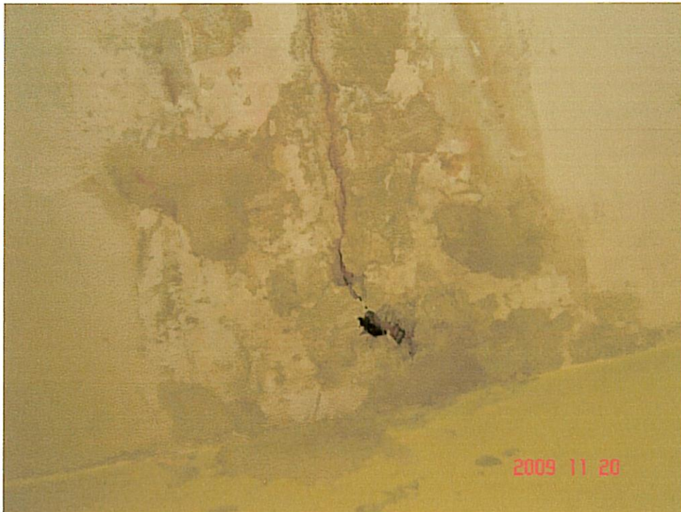
Fot nr 3. Zawilgocenia sufitów
