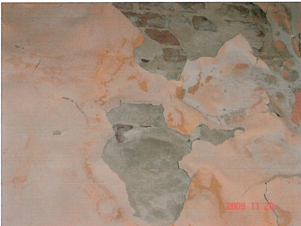
Fot nr 2. Odpadające tynki i malatura ścian
