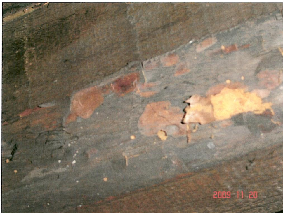
Fot nr 7. Otwory wlotowe (ślady żerowania spuszczela)
